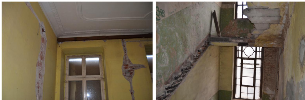
Rys. 8. przykłady kradzieży elementów konstrukcyjnych i instalacyjnych. Źródło: archiwum BZB Projekt.
