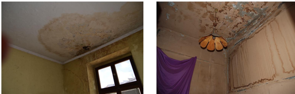
Rys. 5. przykłady uszkodzeń stropów niższych kondygnacji z powodu przecieków poszycia dachowego. Źródło: archiwum BZB Projekt.
